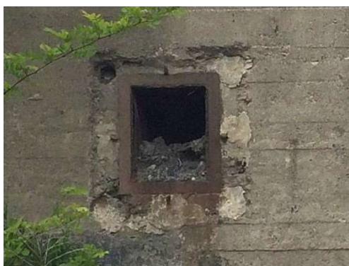
Fot. 12. Czerpnia powietrza w schronie Goduła 14. Widoczne cztery kotwy oraz zaplombowane otwory montażowe.
