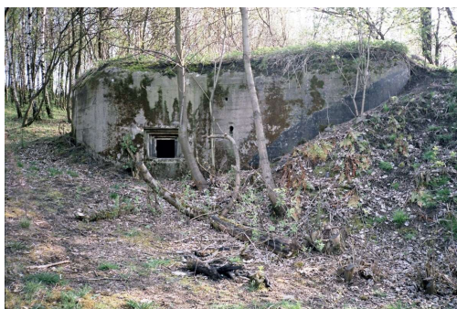
Fot. 02. Ściana boczna schronu ze strzelnicą ścienną ckm. Po prawej od strzelnicy ślad po wyprowadzeniu komina. Stan na początku obecnego stulecia. Fot. Jarosław Ptaszkowski.
