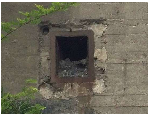
Fot. 12. Czerpnia powietrza. Widoczne cztery kotwy oraz zaplombowane otwory montażowe.
