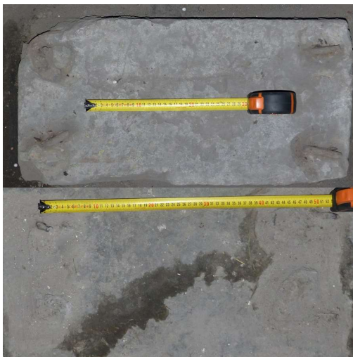
Fot. 07. Porównanie mocowań wentylatorów ręcznych w schronie Goduła 14 (na górze) oraz Bobrowniki 50 [1936] (na dole).
