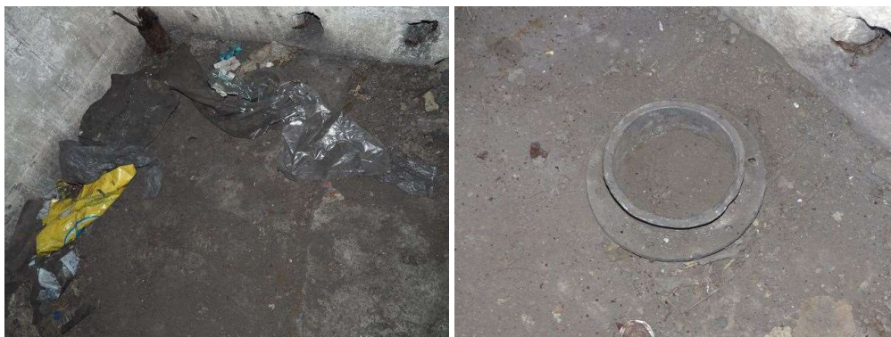
Fot. 11. Kanał podłogowy w izbie załogi. Przy ścianie widoczne kanały podłogowego w izbie załogi. stalowy profil.
