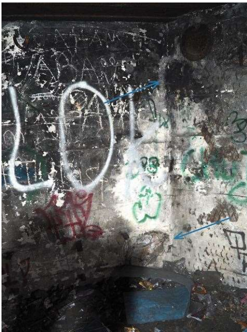
Fot. 07. Róg izby bojowej, w którym stał piec. Strzałki wskazują czerpnię pieca i komin. Rozkucia te zostały zaślepione po wojnie.
