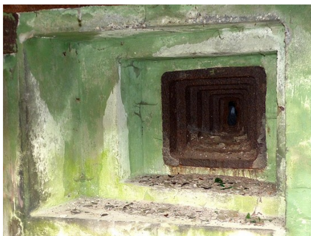
Fot. 33. Czechosłowacki pancierz przeznaczony dla strzelnicy do obrony zapola schronu nr 3. Uwagę zwraca podobne głębokie osadzenie pancierza jak w obiekcie rumuńskim, co wymuszone zostało znaczną grubością ściany. Fot. Łukasz Drzensła.
