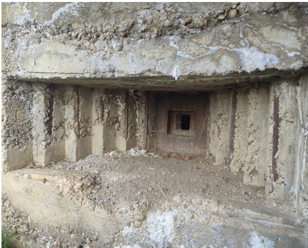
Fot. 22. Strzelnica pomocnicza w schronie nr 1. Uwagę zwraca szerokie stopniowanie przeciw rykoszetowe uformowane w betonie, jednak tylko w osi pionowej.
