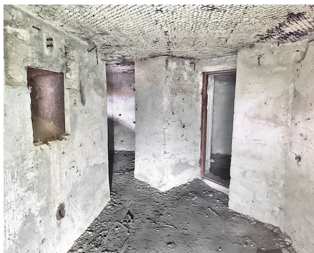
Fot. 11. Wnętrze izby bojowej schronu nr 3. W tym przypadku zauważyć można już charakterystyczne elementy mocowania czechosłowackiej lawety fortecznej DZ-19, co oznacza że lawetę skutecznie osadzono.
