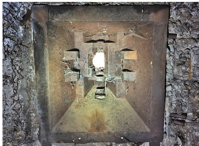
Fot. 21. Rumuński pancierz widoczny od wewnątrz, wyraźnie widać podobieństwo do czechosłowackiego pancierza strzelnicy schronów LO vz. 37, na którym to pancierz był niewątpliwie wzorowany.
