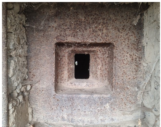
Fot. 25. Pomocnicza strzelnica zastosowana w schronie nr 1 (być może również w schronie nr 2) rumuńskiego projektu. Pancierz sprawia wrażenie, znacznie bardziej rodzimego rozwiązania, niż ma to miejsce w przypadku większego pancierza. Uwagę zwraca minimalne stopniowanie przeciw rykoszetowe, przy stosunkowo dużej grubości płyty.
