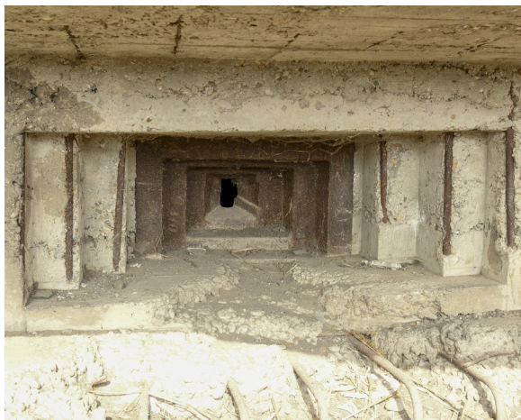
Fot. 20. Widok na strzelnicę rumuńskiej produkcji. Uwagę zwraca znaczna grubość pancierza, oraz podobieństwo ukształtowania otworu strzelniczego, do tego w czechosłowackim panczerzu dla schronów LO vz. 37.
