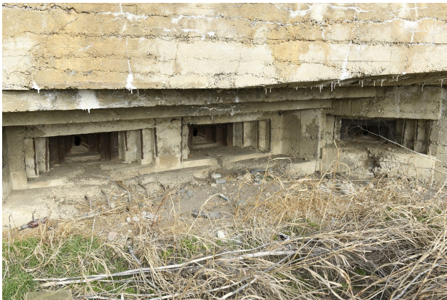
Fot. 18. Schron nr 1. Widok na prawą kazamatę. Wyraźnie widać trzy oryginalne rumuńskie panczerze. Prawa strzelnica (flankująca strzelnicę główną), jest nieco inna co spowodowane było prawdopodobnie, zmodyfikowanym sposobem produkcji. Wyraźnie widać również 15-20 cm warstwy jakimi przeprowadzano betonowanie obiektu.
