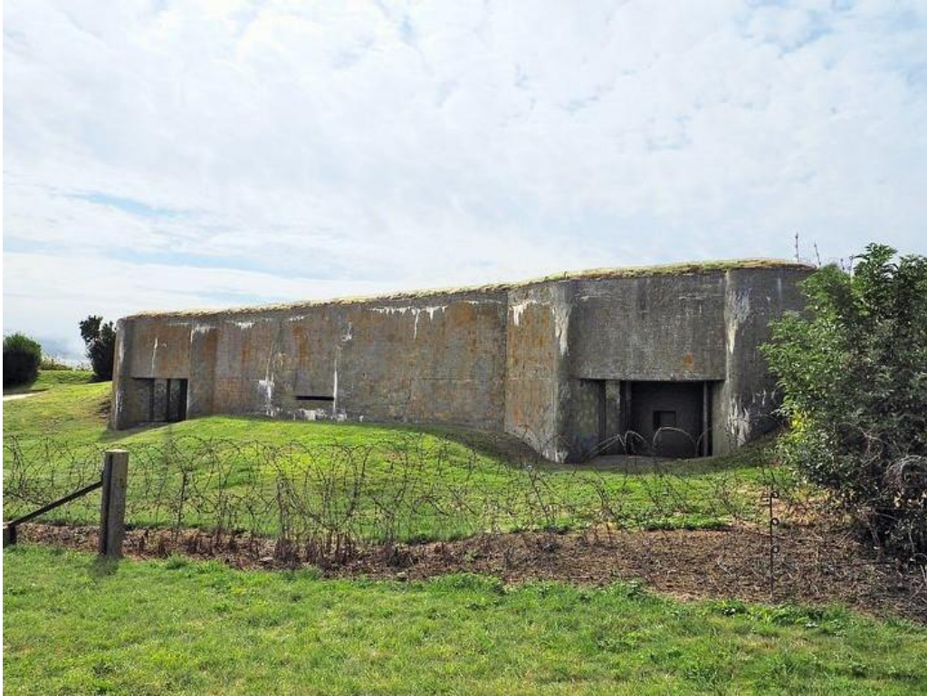
Fot. 01. Schron VI od czoła. Po prawej stronie kadru strzelnica armaty ppanc, na lewo od centrum kadru szczelina obserwacyjna, po lewej druga strzelnica armaty ppanc. Fot. Łukasz Drzensła.
