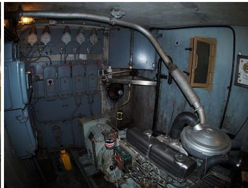
Fot. 12. Maszynownia "B" (na zapleczu schronu IV). Fot. Łukasz Drzensła.
