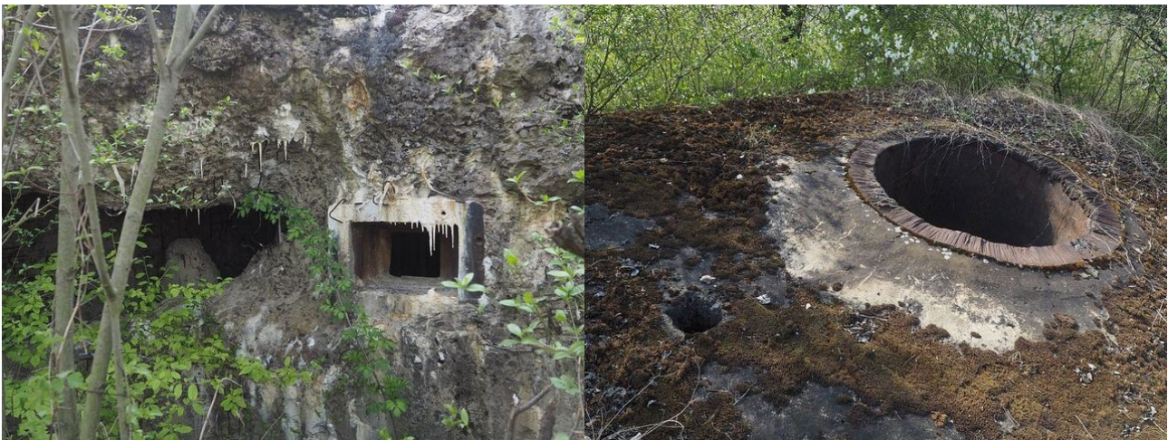
Fot. 08. Uszkodzona wybuchem ściana boczna schronu Fot. 09. Strop schronu 206. Po prawej stronie destrukcja schronu 206. Po prawej stronie kadru pancerny DOT-4. Widać ślady kopuły pancernej. Po lewej otwór peryskopu, ostrzału.
