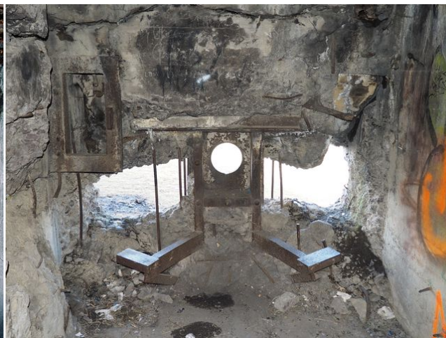
Fot. 13. Nieco uszkodzona wybuchem strzelnica w schronie Węgierska Górka 6 "Wyrwydąb" prezentuje szczegóły konstrukcyjne, w tym mocowanie profilu łukowego (środek wycięty) do konstrukcji montażowej pancerza. Fot. Łukasz Drzensła.
