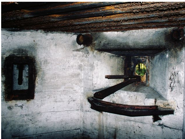
Fot. 12. Strzelnica ckm z 1939 r. z podstawą ckm opartą o stalowy profil łukowy wykonany z trzech pospawanych ceowników. Schron Wiry 6, stan w 1997 r. Fot. Marcin Dudek.
