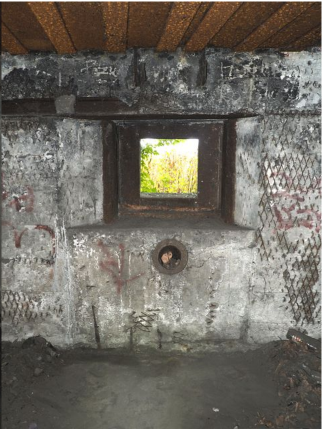
Fot. 03. Strzelnica ckm typu 37 w schronie Godula 13. Zwraca uwagę sporych rozmiarów rozglifienie z drobnymi schodkami. Fot. Łukasz Drzensła.
