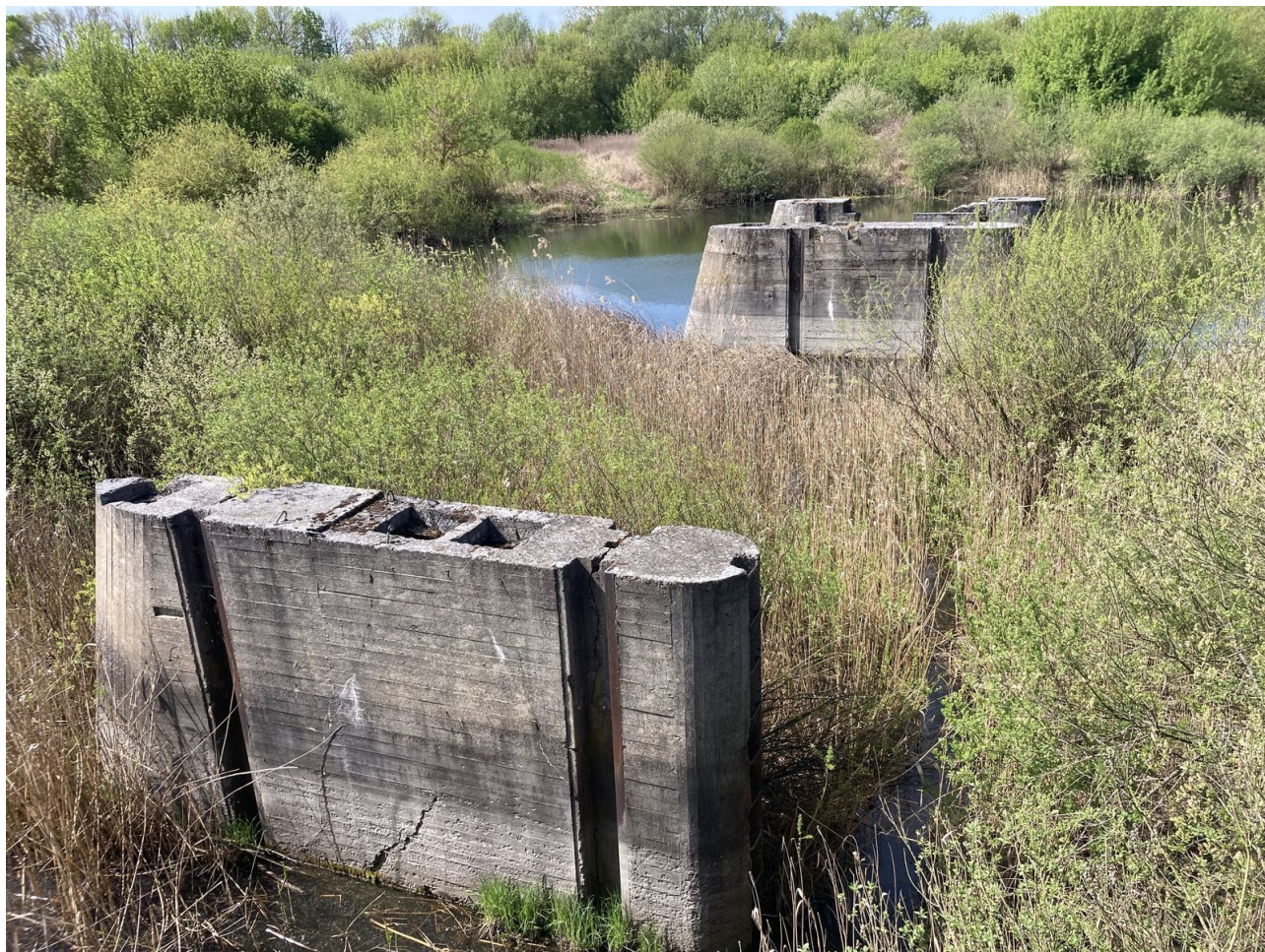
Fot. 01. Widok na jaz "Mstyszyn" z przęsła na planowanym prawym brzegu Styru. Jaz posiada komory minowe w formie rur w filarach.
