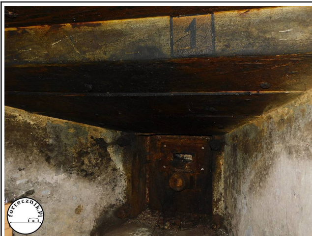
Fot. 27. Zachowany oryginalny numer strzelnicy nad stanowiskiem bojowym we wschodniej izbie bojowej w schronie północnym.
