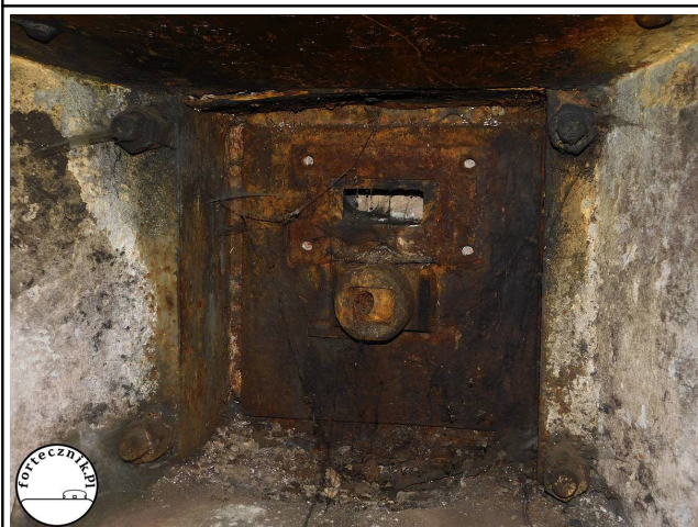
Fot. 24. Gazoszczelny pancerz strzelnicy ckm. Pancerze, jakie zastosowano w omawianych schronach, składały się z dwóch płyt stalowych, a przestrzeń między nimi wypełniona była betonem. Na zdjęciu pancerz bez przeziernika, za to z zachowanym jarzmem kulistym.
