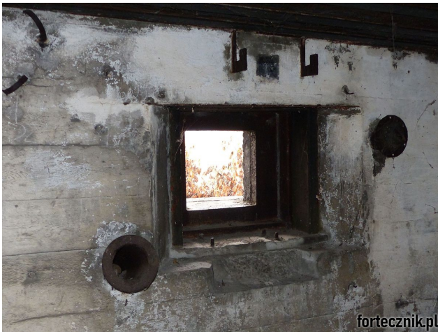
Fot. 10. Stanowisko bojowe ckm w schronie nr 76 (p.o. "Kochłowice"), to samo, co na fot. 05. Pod sufitem znajdują się dwa haki wspomagające montaż pancerza. Sam pancerz zagospodarowano na nowe cele.
