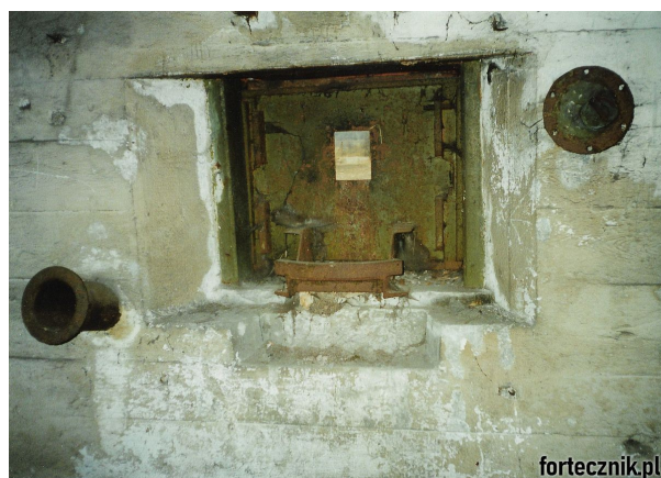
Fot. 05. Fotografia dokumentalna przedstawiająca stanowisko bojowe ckm w schronie nr 76 (p.o. "Kochłowice"). Zachowany pancierz, rama dociskowa pancierza z klinami (choć z jedynie jedną śrubą) oraz dolny element podstawy fortecznej typu 37. Fot. P.M. & W.M.
