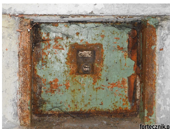
Fot. 06. Pancierz z fot. 04 od wewnątrz. Rama dociskowa zdemontowana. W miejscu, gdzie się znajdowała dobrze widać autentyczny pomarańczowy podkład antykorozyjny, którego niestety nie można obejrzeć w żadnej izbie muzealnej urządzonej w polskim schronie bojowym.
