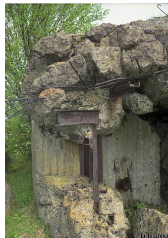
Fot. 09. Zniszczona strzelnica ckm w jednym ze schronów odcinka "Sarny". dobrze widoczna konstrukcja montażowa pancerza oraz wzmocnienie stopniowania przeciwykoszetowego. Fot. J. Sadowski.
